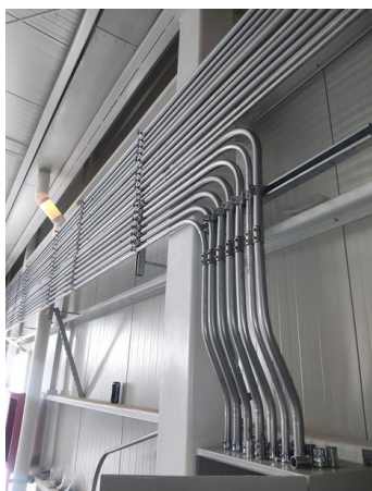
Canalización conduit galvanizada en pared perimetral
