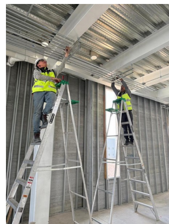
Instalación en altura sobre muro perimetral
